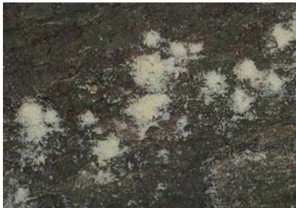
Das viele weisse Bohrmehl deutet auf einen Befall durch den Werftkäfer hin.
