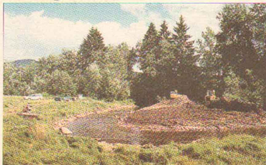
Die erste von sechs zur Wiederherstellung vorgesehenen Mäanderschleifen des Kolbersbaches wurde als Teststrecke bereits im Juni mit Bagger- und Laderampe angelegt.
